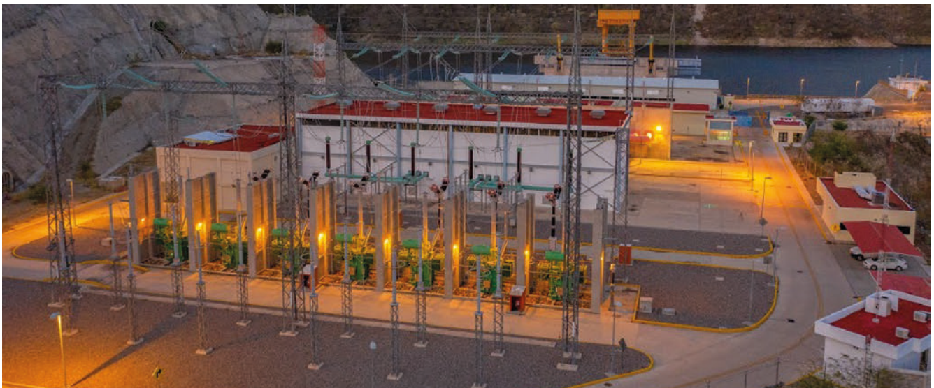
Fotografía 12. Subestación de transmisión, Central Hidroeléctrica “La Yesca”. La Yesca, Nayarit. | Comisión Federal de Electricidad.
