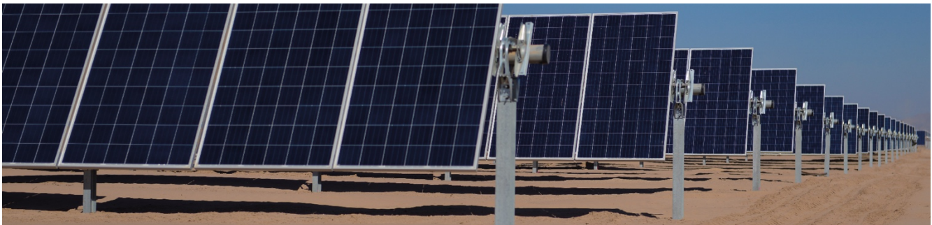
Fotovoltaica. Parque Solar Villahermosa, Tabasco. | Comisión Federal de Electricidad.
