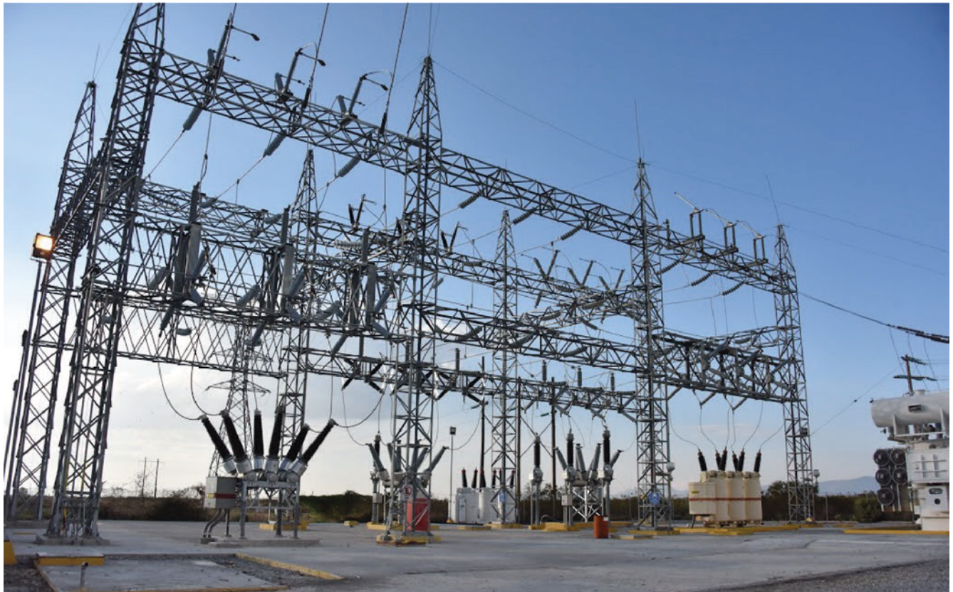
Fotografía 19. Subestación de distribución. | Comisión Federal de Electricidad.
