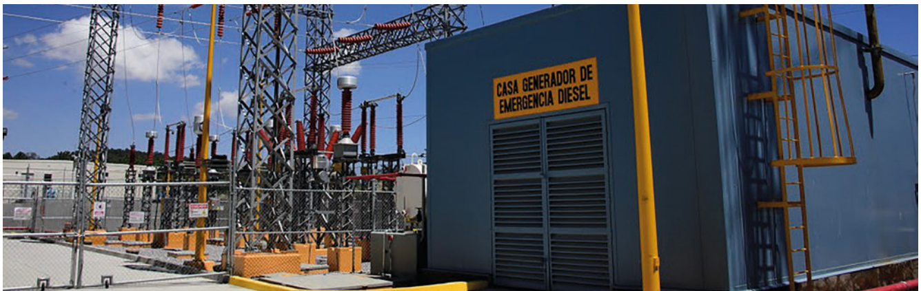
Fotografía 16. Subestación de transmisión. | Comisión Federal de Electricidad.
