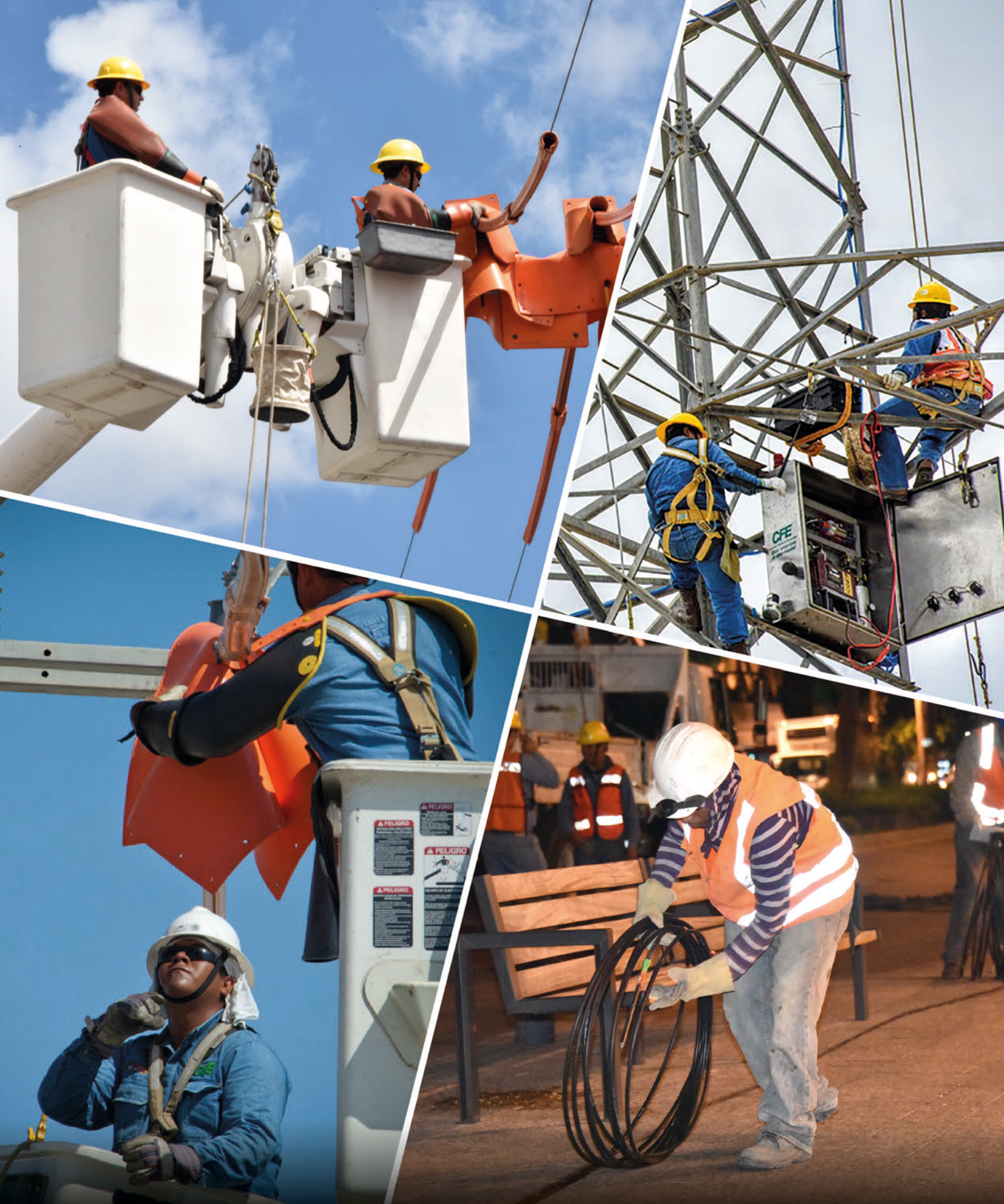
Fotografía 21. Instalación de dispositivo para tirado de conductores en alta tensión. Colocación de protectores a línea. Cableado Centro Histórico, CDMX. | Comisión Federal de Electricidad.
