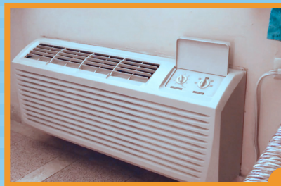
Equipo de baja eficiencia
